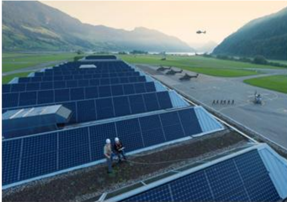
Abb. 22 Photovoltaikanlage Militärflugplatz Alpnach
