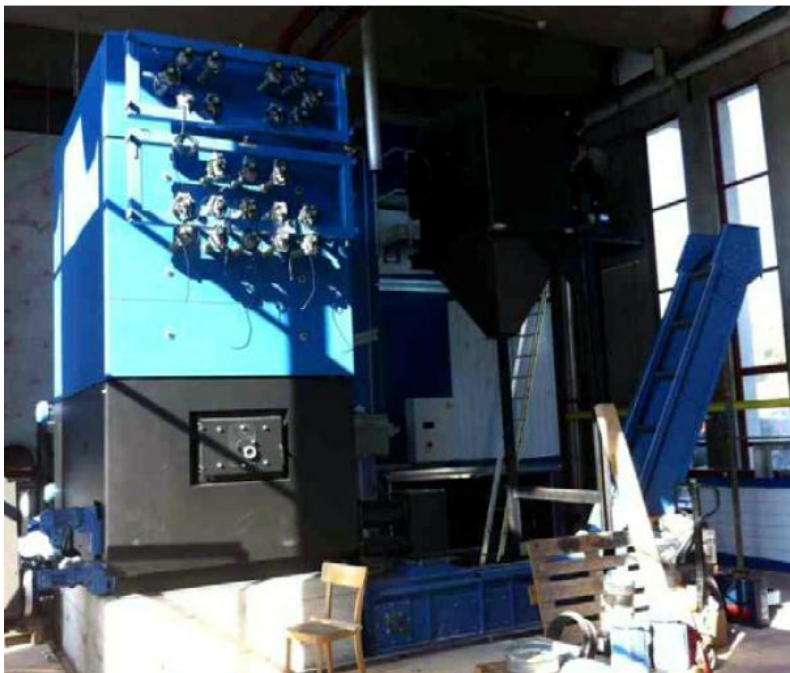
Abb. 13 Die neue Holzsnitzelheizung in Changins
